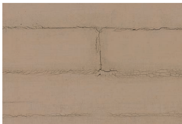
図12 ④長片方向に直交している亀裂（木摺継ぎ目）
