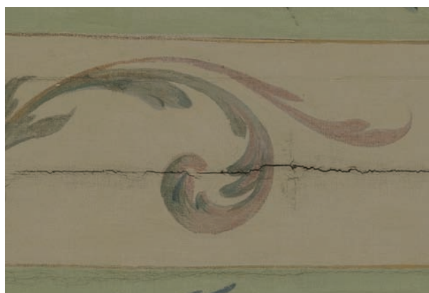
図11 ③線状の亀裂
