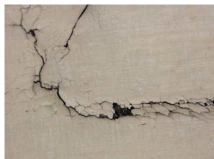
図18 図17の剥落部分拡大
