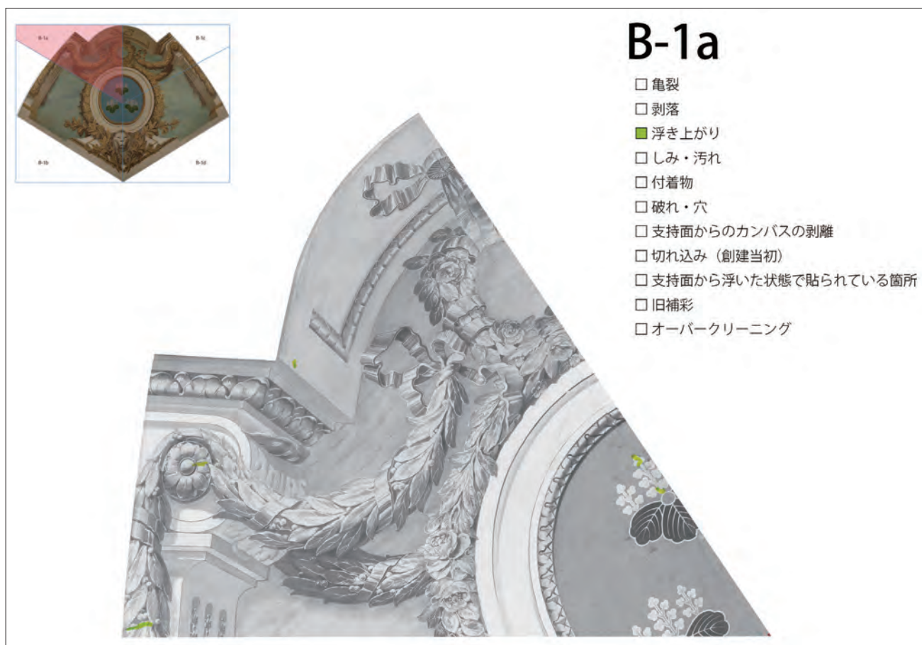
図 3-2-34 壁画 B-1 浮き上がり
