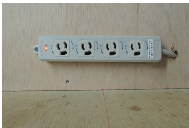
図4-1-3 仮設足場に設置された電気コンセント
