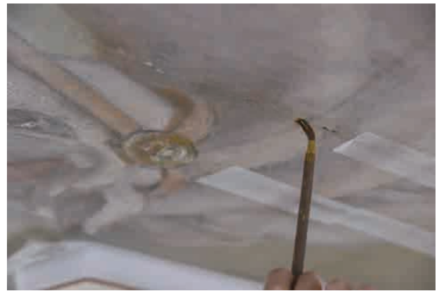
図 2-4-43 再浮き上がり接着 絵具層亀裂部分に膠水を含浸させた。
