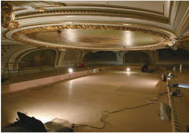
図 2-2-17 赤外線撮影 照明の設置
