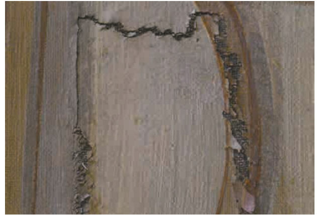
図 2-2-56 天井絵画 修復前 絵具層の浮き上がり
