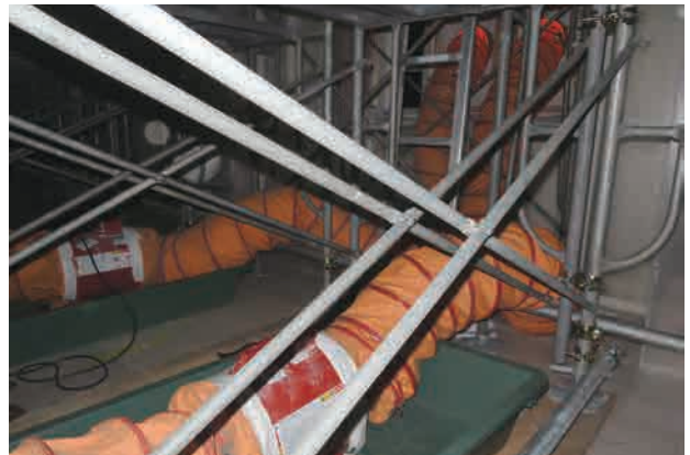
図2-4-4 仮設足場に設置された送風機
