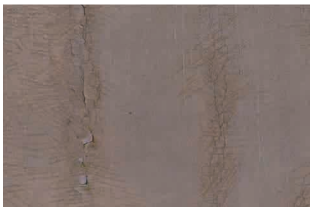
図2-2-51 天井絵画 修復前 充填剤の浮き上がり
