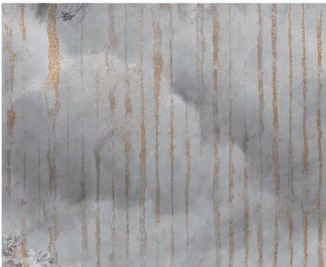
図 2-2-39 状態記録表 6F (亀裂)
